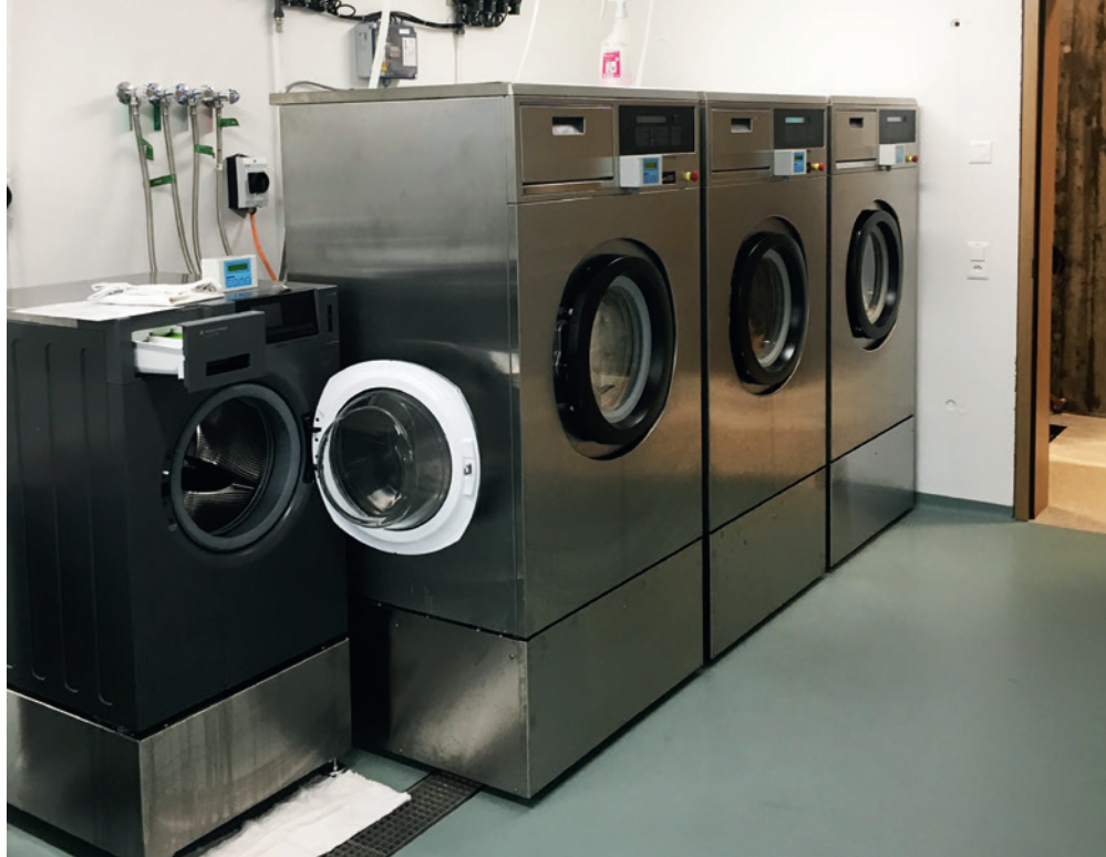
La nouvelle buanderie maison de la Burgergut dans la ville bernoise de Steffisburg
